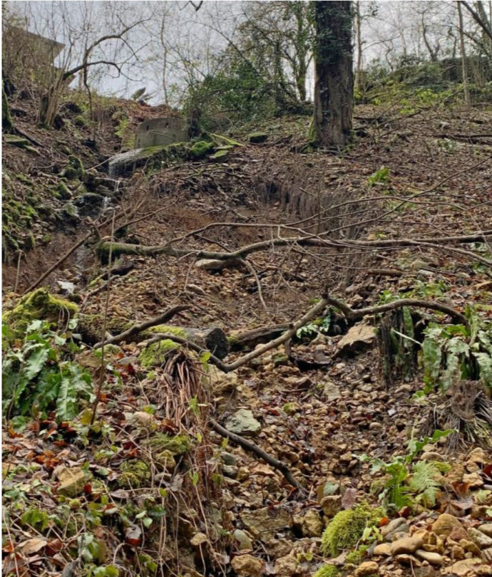
Figure 3 : Érosion / glissement en dessous de la chambre circulaire
