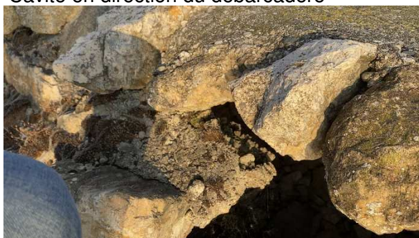
Trou ayant permis d'identifier le problème
