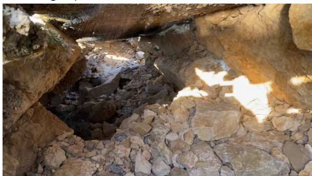
Cavité en direction du débarcadère
