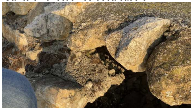
Trou ayant permis d'identifier le problème
