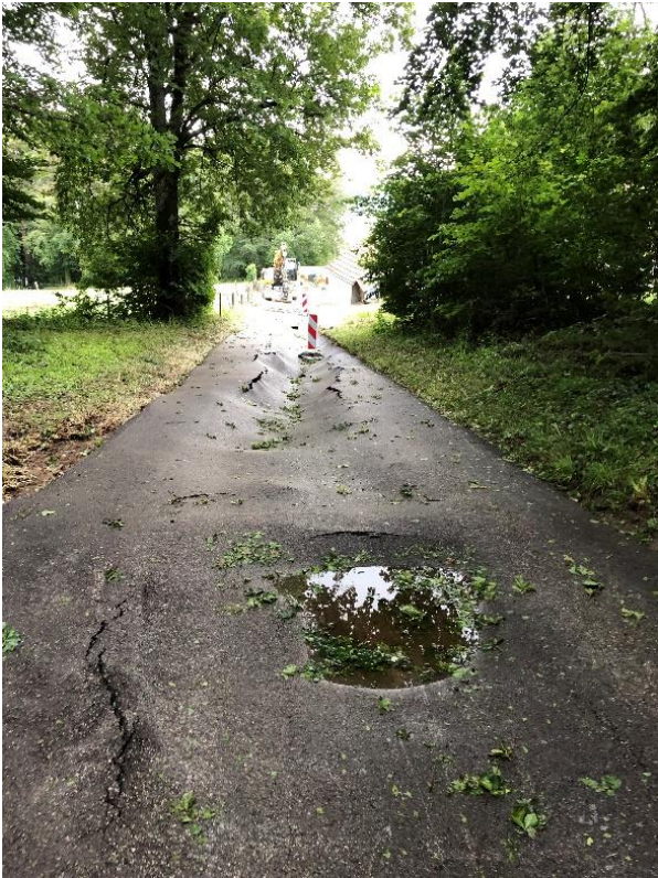
Photos de la chaussée après l'orage :
