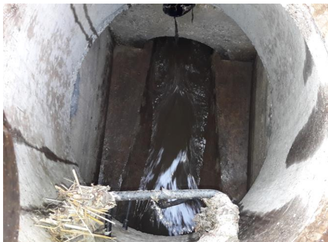
Chambre 116 : rétrécissement du collecteur avec traces de mise en charge
