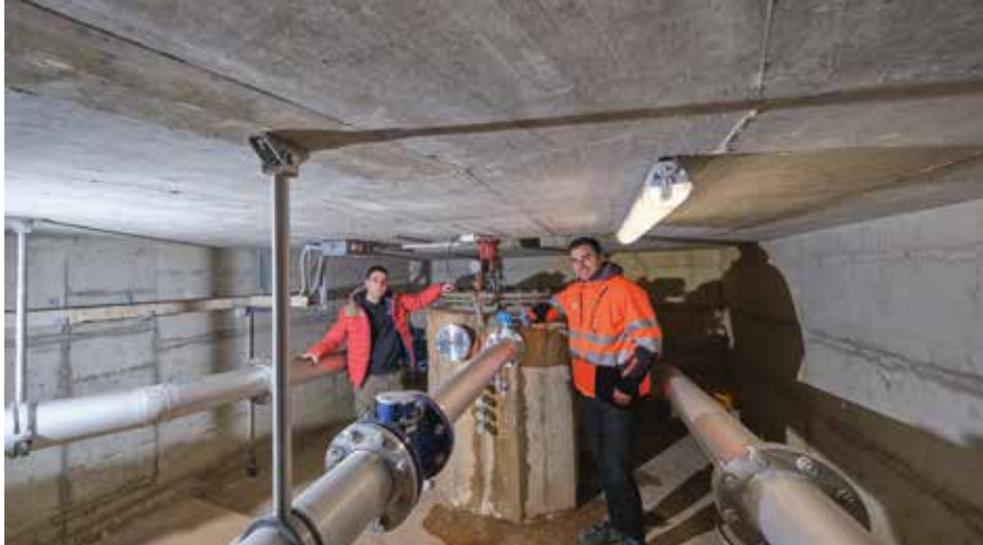
En surface, protégée dans son «bunker», la résurgence du puits artésien de Treytel. A la verticale, 300 m plus bas, la nappe d'eau.
